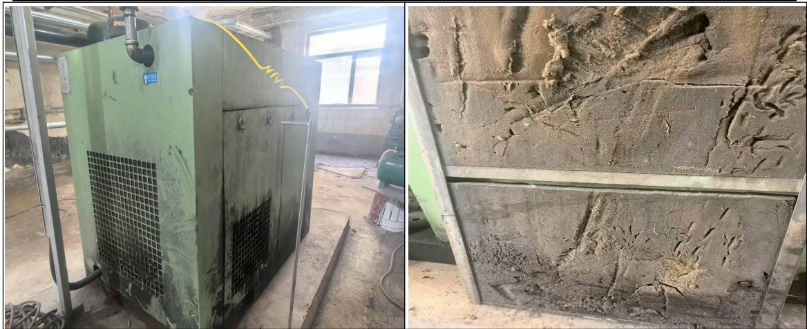
风机内壁安装吸声材料
