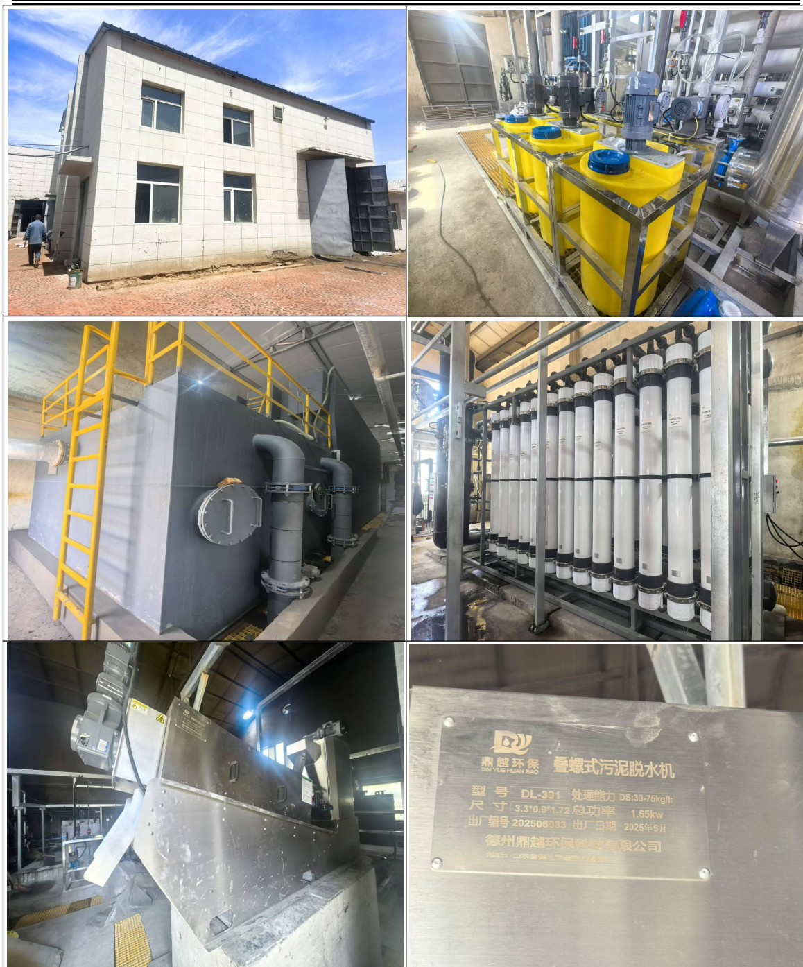
矿井水处理站
