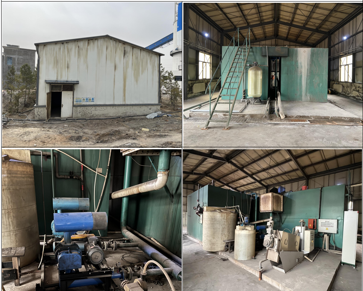
生活污水处理站
